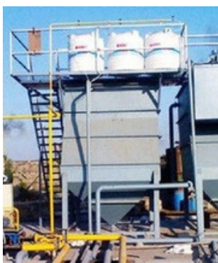
ETP PLANTS (Effluent Treatment Plants)
