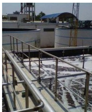
CETP PLANTS (Common Effluent Treatment Plants)
